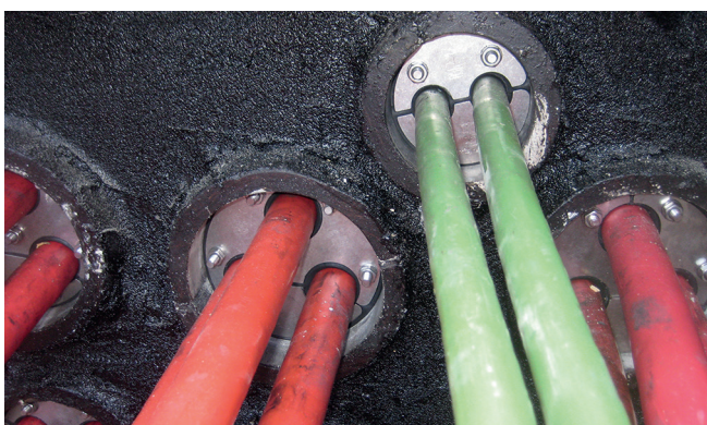
Tous les câbles ont été étanchés ultérieurement avec des joints annulaires en caoutchouc HRD fabriqués sur mesure et placés dans les gaines.
